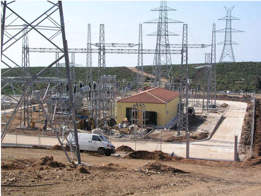
Τυπικός υποσταθμός Υ.Τ. 50.000 KVA, 150/21 kV
